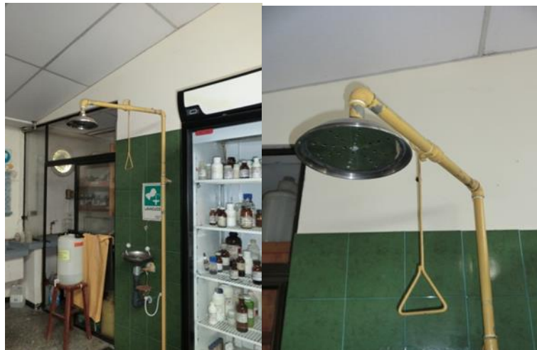
Figura 11. Ducha de Seguridad. Fuente: Elaboración propia
