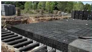
Depósitos de infiltración
