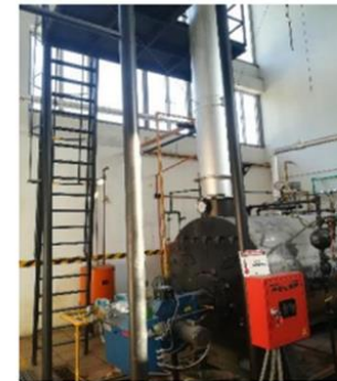
Fuentes fijas de contaminación: Calderas
