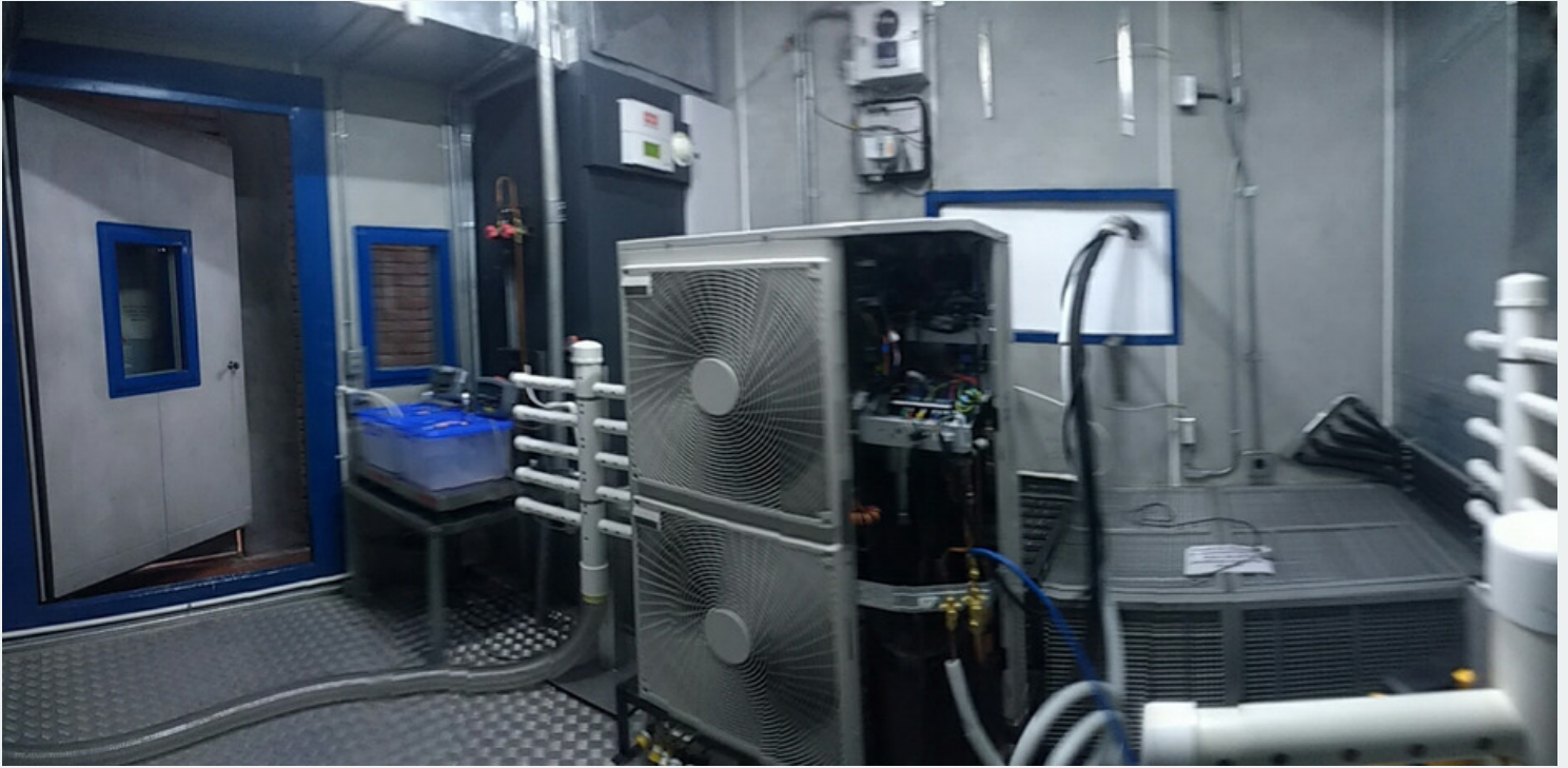
Laboratorio de Ensayos para Equipos Acondicionadores de Aire - LPEA
