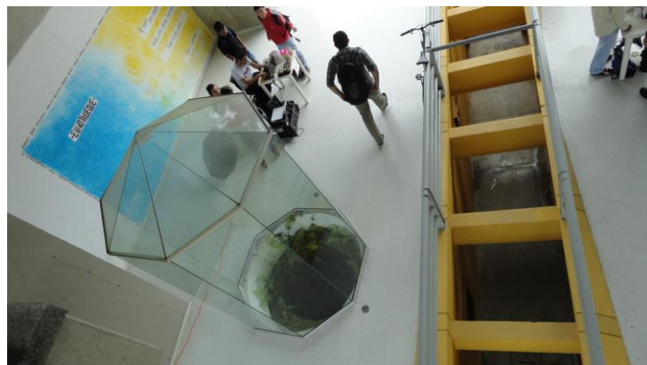
Foto 158: Detalle del corredor y vidrio que cubre la entrada a la estructura funeraria. Nótese las dificultades por crecimiento de plantas
