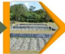
Plantas de Tratamiento de Aguas Residuales
