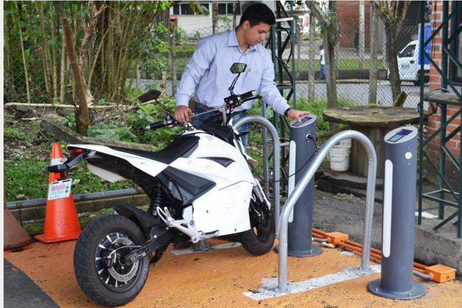
Punto de Recarga de Motos y Bicicletas Eléctricas con Energía Solar
