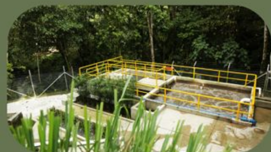
Plantas de Tratamiento de Aguas Residuales
