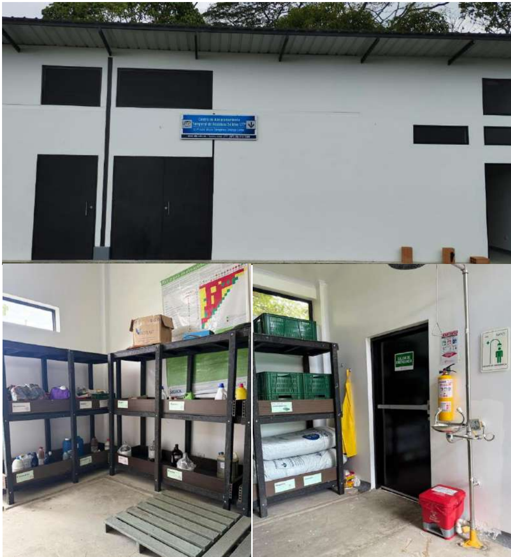
Figura 10. Centro de almacenamiento temporal de otros residuos o desechos peligrosos
