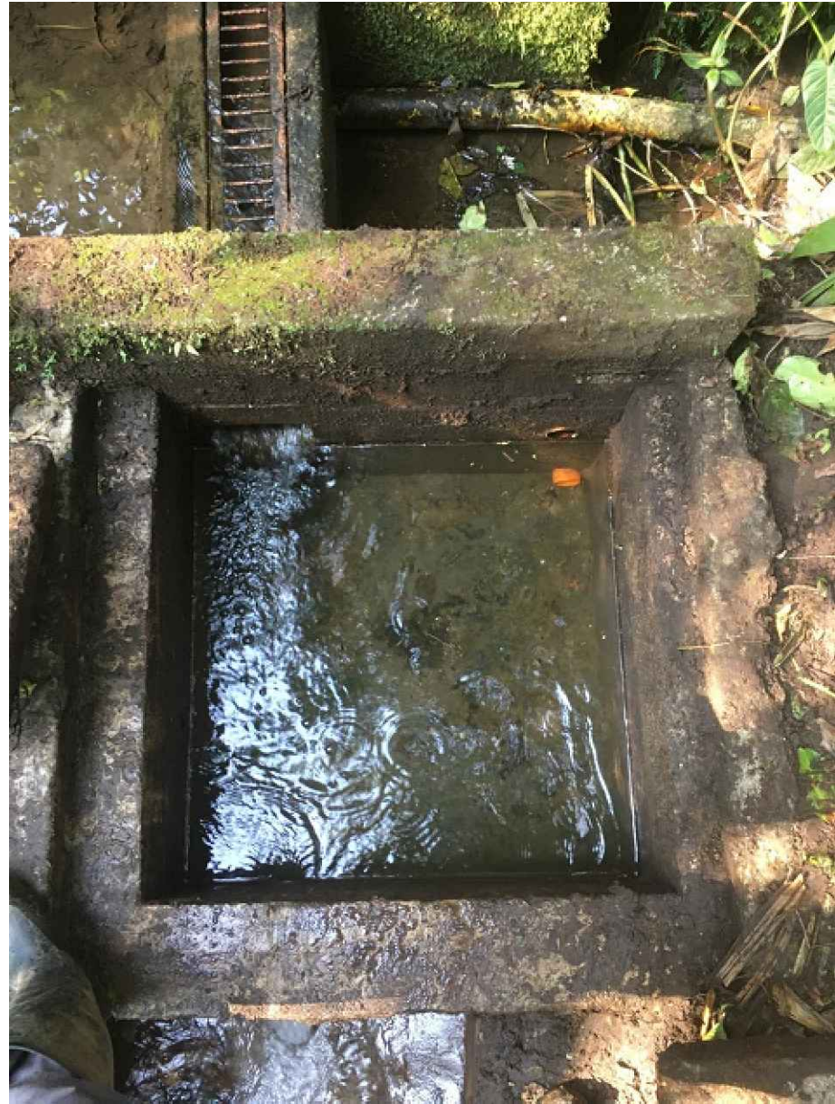
FOTOGRAFIA N° 5 CAJA DE CAPTACIÓN BOCATOMA N° 1
