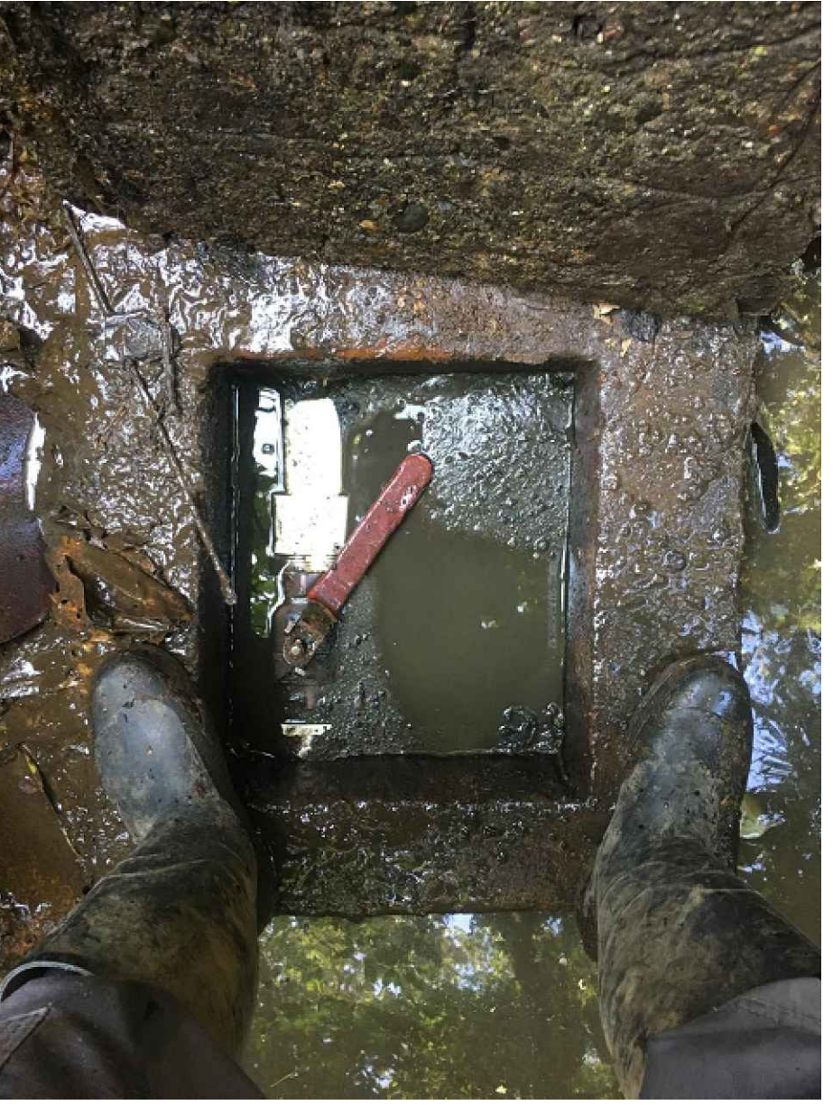
FOTOGRAFIA N° 2 CAJA DE VÁLVULA BOCATOMA N° 1
