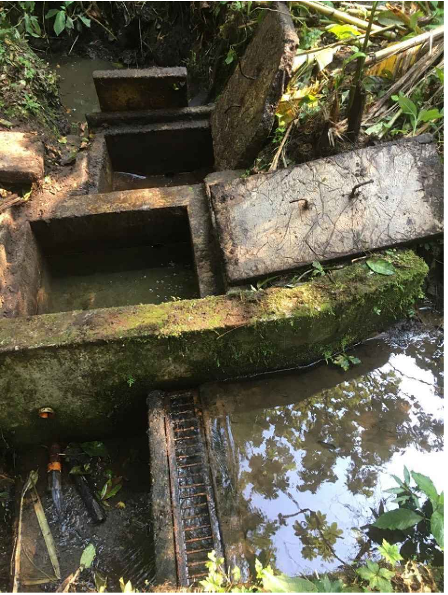
FOTOGRAFIA N° 3 CAJA DE CAPTACIÓN BOCATOMA N° 1
