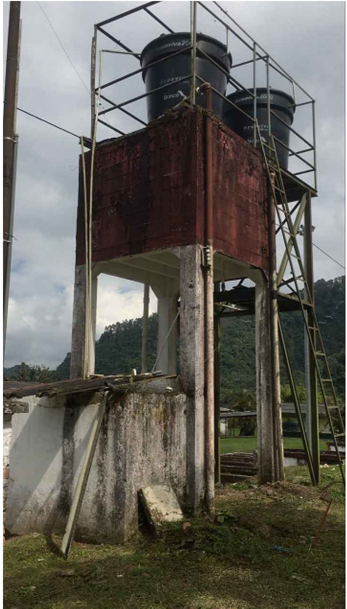
FOTOGRAFIA N° 9 TANQUE DE ALMACENAMIENTO
