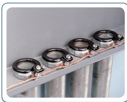
Figura 7. Foto de Equipotencialización de tuberías
