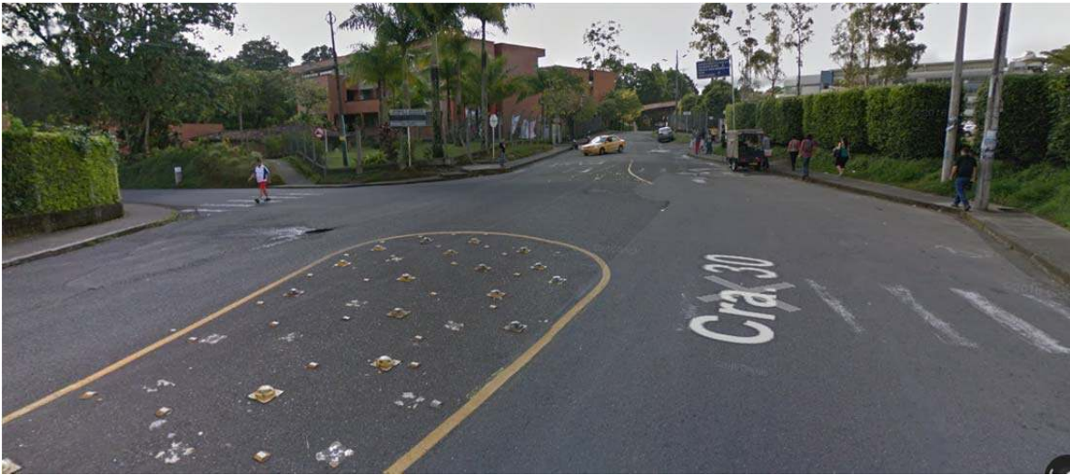
Fotografía 7. Cebras peatonales que deberán ser repintadas.
